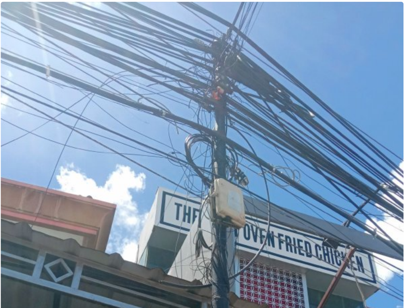
Kabel fiber optik perusahaan ISP yang semrawut
